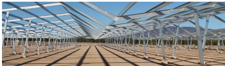
Marquesinas Parking "Fotovoltaico" Aeropuerto Corvera.
